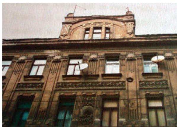
Sl.11. Neprimjerene intervencije postavljanja satelitskih antena na objektu
