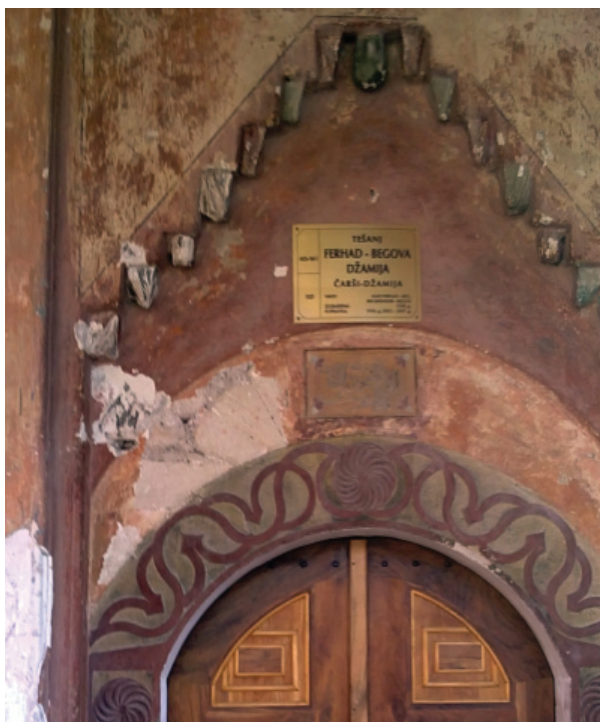
Sl.32. Izgled portala prije čišćenja
