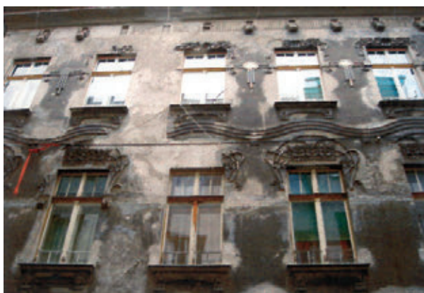
Sl.9. Trenutno stanje pročelja i posljedice degradacije
