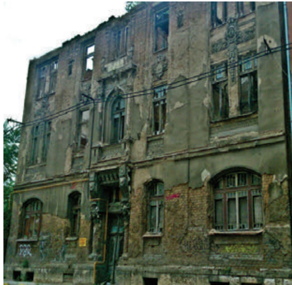
Sl.13. Potpuna degradacija arhitektonske plastike
