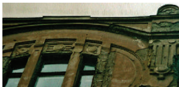
Sl.12. Degradacija arhitektonske plastike i fasadnog zida
