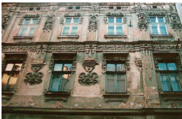
Sl.6. Rastreseni i nestabilni slojevi maltera i gubitak elemenata arhitektonske plastike
