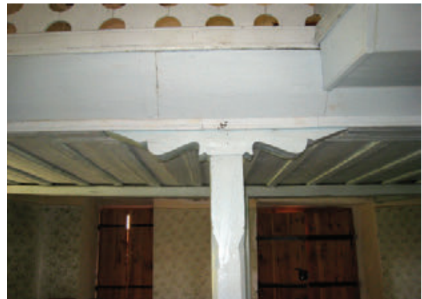
Sl.23. Originalni stub zatečeno stanje
