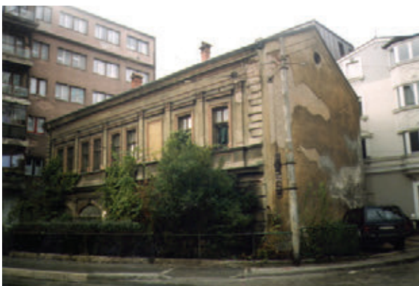
Stanje prije konstruktivne sanacije
