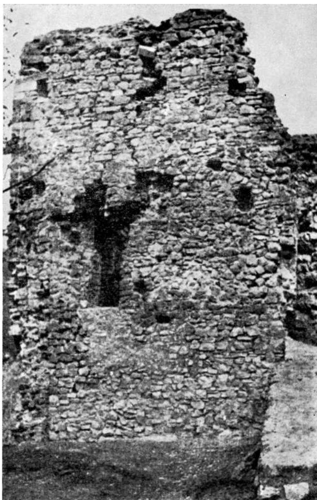
5. Teško oštećena donžon-kula. Osim pukotine pri vrhu zida, kula je na zapadnoj strani i potkopana, tako da postoji latentna opasnost od rušenja.
