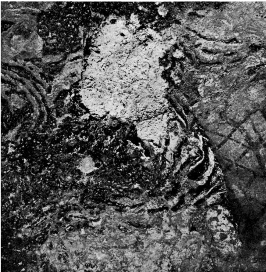
Sl. 2 Detalj živopisa oštećenog od vlage na severnom zidu crkve
