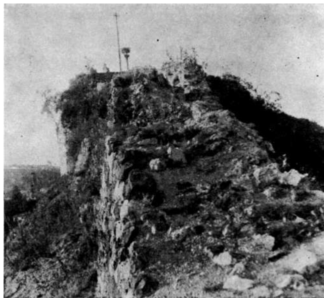
Sl. 9 Zapadni dupli zid g. tvrđave u toku obrušavanja u svrhu traženja zdrave podloge.
