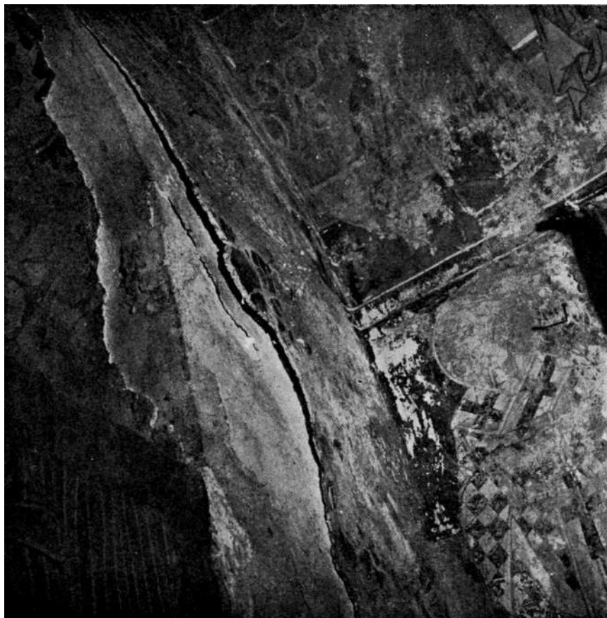
Sl. 6. Detalj oštećenja u đakonikonu na kome se vide međusobno razdvojeni slojevi maltera
