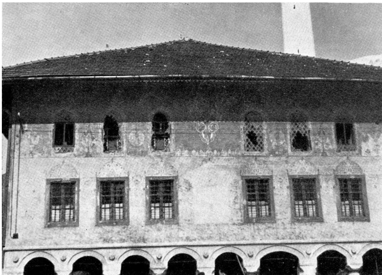
Sl. 1. Sulejmanija džamija u Travniku, južni zid. Naziru se ostaci starije ornamentike ispod novijih premaza.
